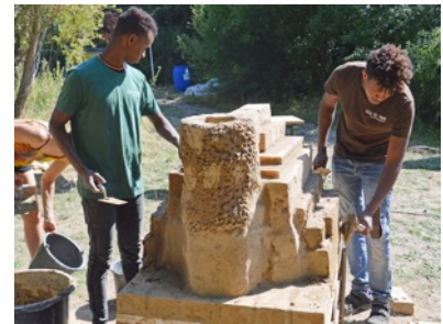
Mauern des Ofens mit Schornstein
